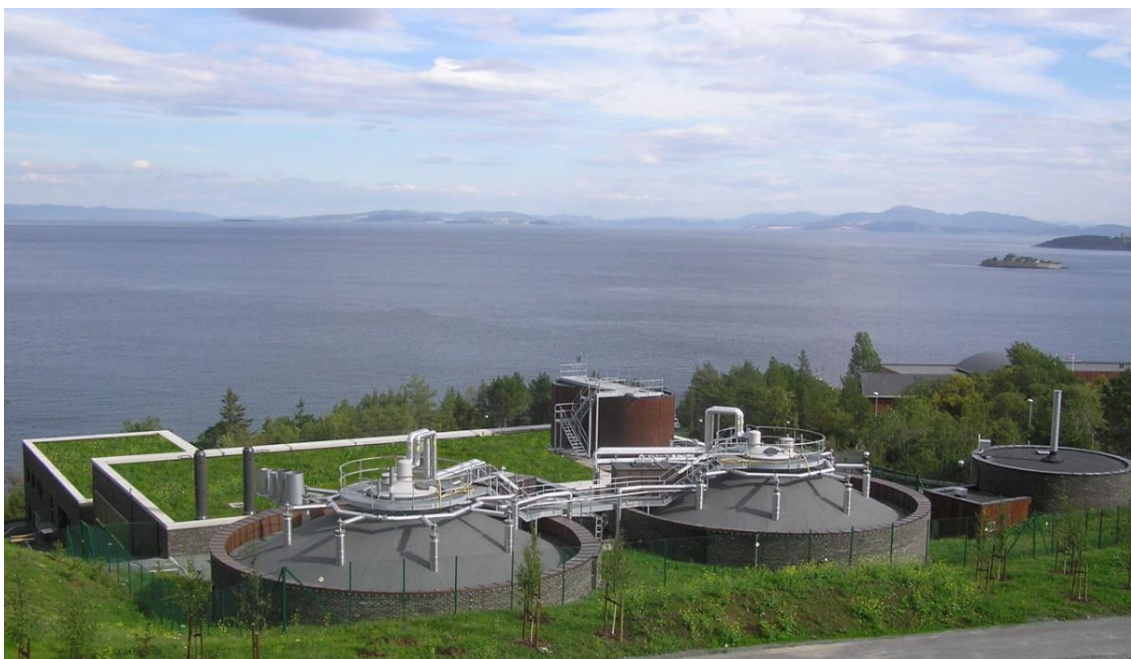
Figur 5. Biogassanlegg ved Høvringen rensanlegg hvor tankene står over terrenget. To råtnetanker og gasstank helt til høyre (Ref. infoark fra Trondheim kommune).
